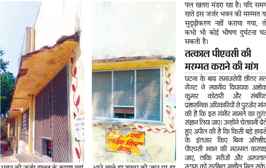
भवन की जर्जर हालत के कारण यहां
